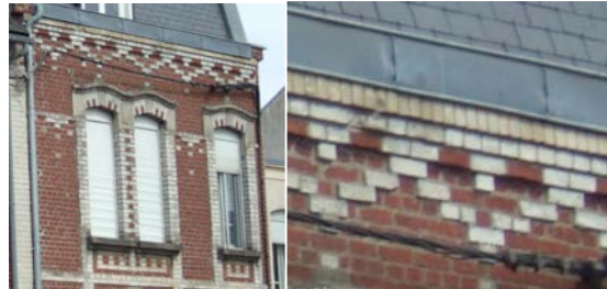
Exemple d'encadrement de baies et de modénatures : la brique souligne et renforce la composition architecturale classique.
