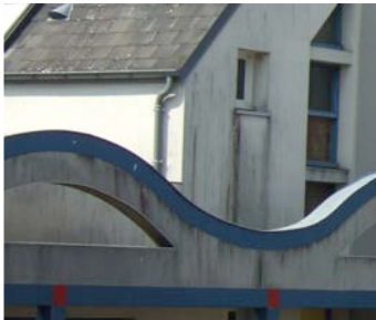
Les traces d'humidité sur les façades affaiblissent l'intérêt de cette forme architecturale.
